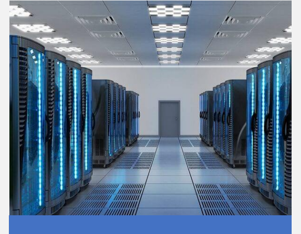
مشروعات مراكز البيانات (Data Centers)
