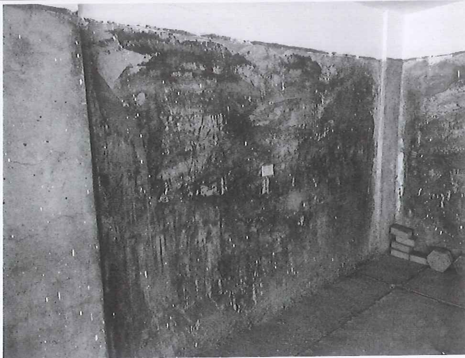
صورة رقم (٥) : نشع وتمليح بحوائط البديوم
