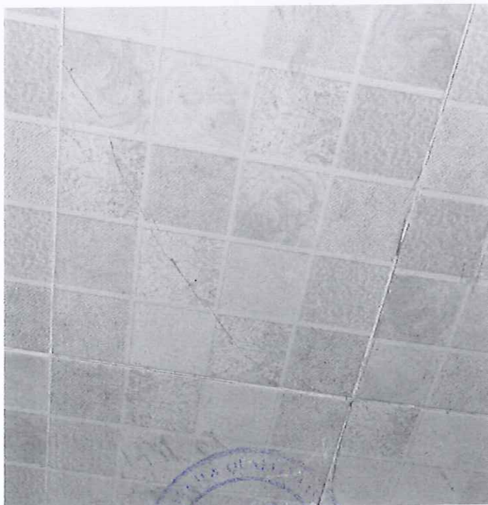
صورة رقم (١٦) : شروخ ببلاط سيراميك الحوائط ببعض الوحدات
