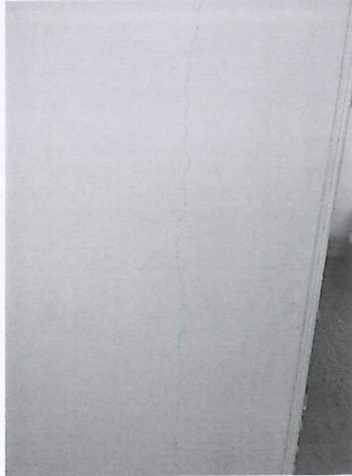
صورة رقم (١٣) : شروخ رأسية فاصلة بين الأعمدة الخرسانية ومباني الحوائط ببعض الوحدات
